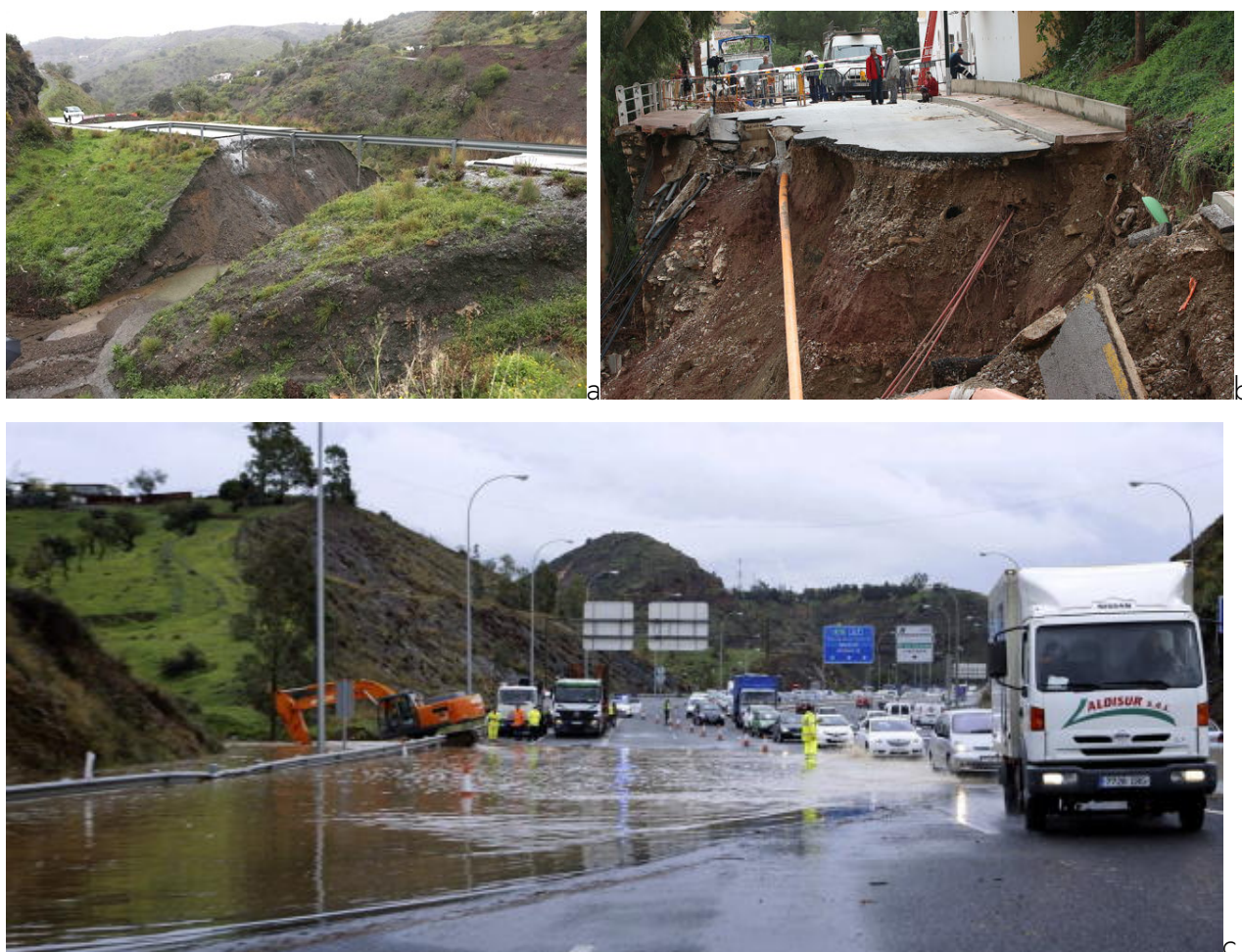
Figura 2. Hundimientos de calzada en Salares (Málaga) (a) y Málaga (b). Balsa de agua en autovía A7 (Málaga) (c).
