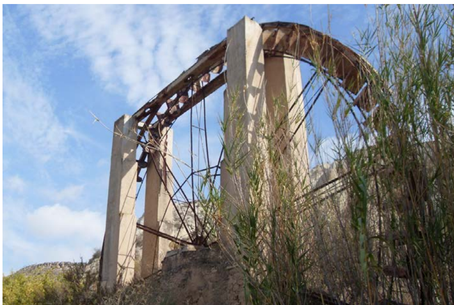
Figura 6. Estado actual de la rueda de corriente baja, noria de Velasco . Regadío tradicional del río Mula, aguas abajo de la pedanía de Los Baños
